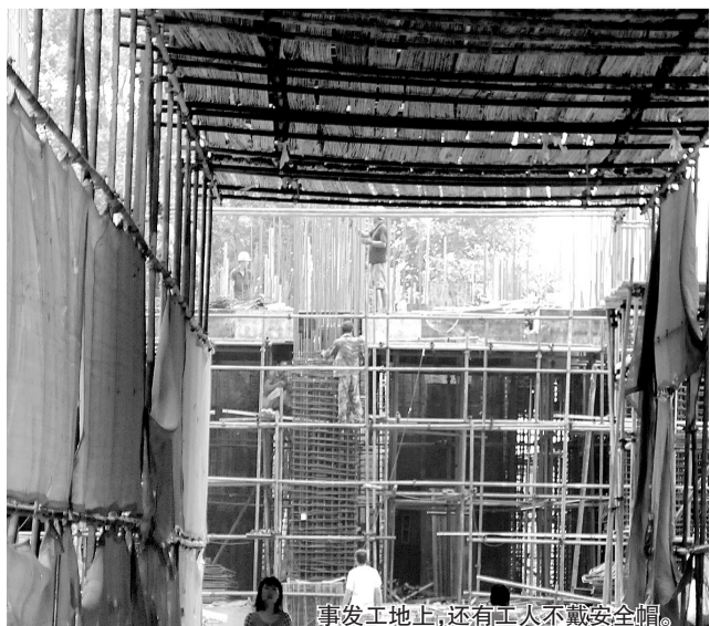
事发工地上，还有工人不戴安全帽。
