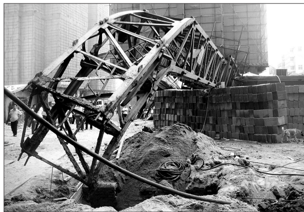
塔吊连根拔起
