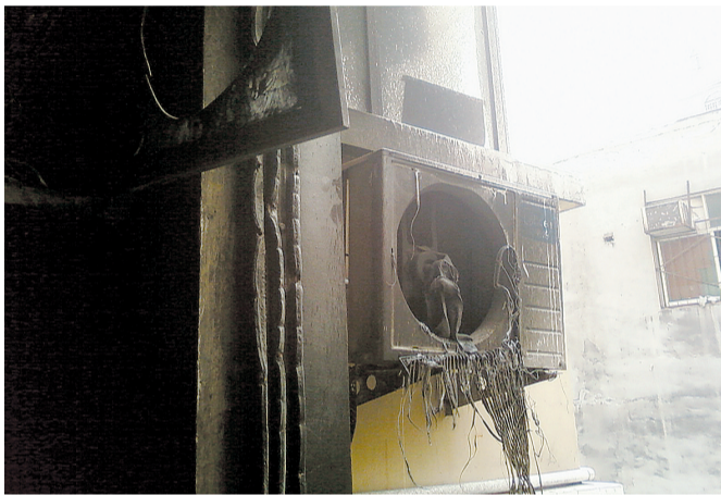
火灾后二楼窗户旁的空调
