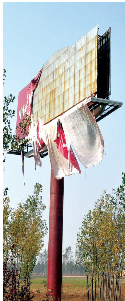
机场高速入口处破烂的广告牌
