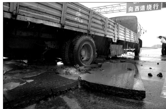
2003年6月29日,西环郑上路立交桥北侧水管爆裂,汽车陷入桥面。
