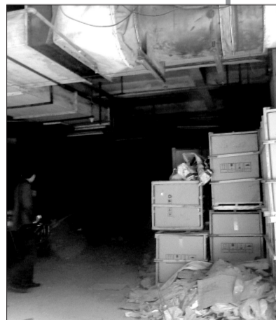
该楼的易燃建材仓库被责令整改
