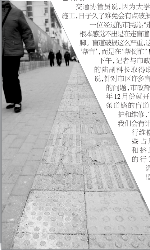
沿路盲道破损严重
