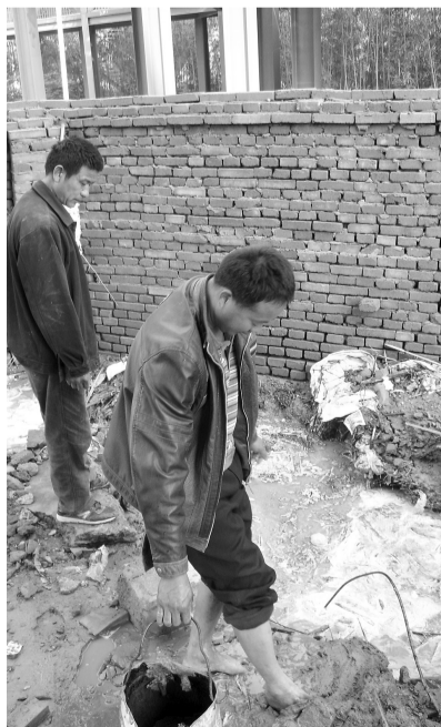
救援人员把水冲入漏气口稀释液化气
