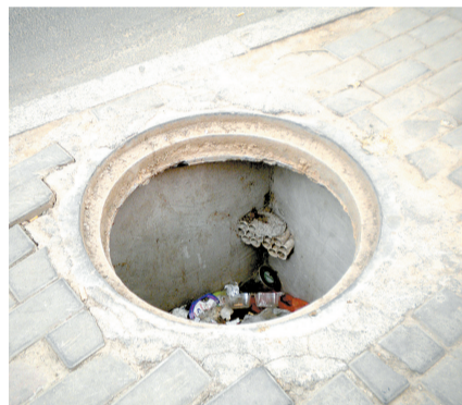
无盖窨井隐患多
