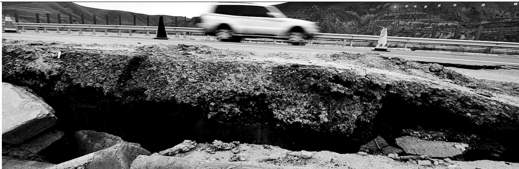
一辆汽车从出现路基沉降的路面旁驶过。
