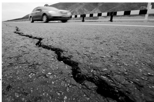
在天定高速通安驿段，一辆汽车从出现裂缝的路面上驶过。
