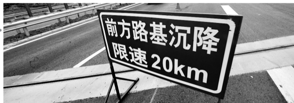
路基沉降路段上竖立的警示牌。
