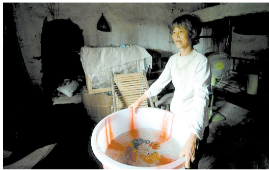
开县文峰街道高市村村民王学清在用盆接房顶漏下的雨水。
