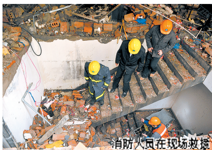
消防人员在现场救援
