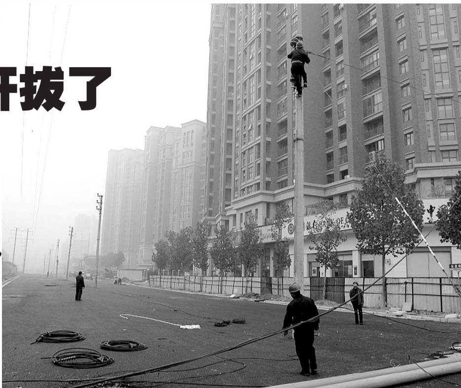
15日下午,经 ZZIC 重点跟踪督办,市建委、市供电公司宋寨南街道路中的6根占道线杆进行了拔除。
