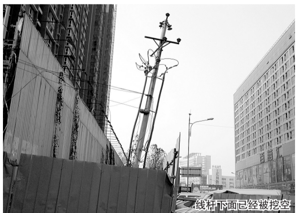
线杆下面已经被挖空
