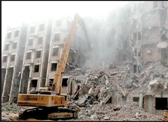
质量有问题,某安置小区拆除重建
