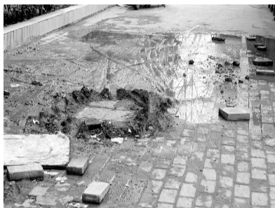
冒水窨井周围,污水横流
