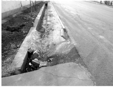
破损的排水沟
