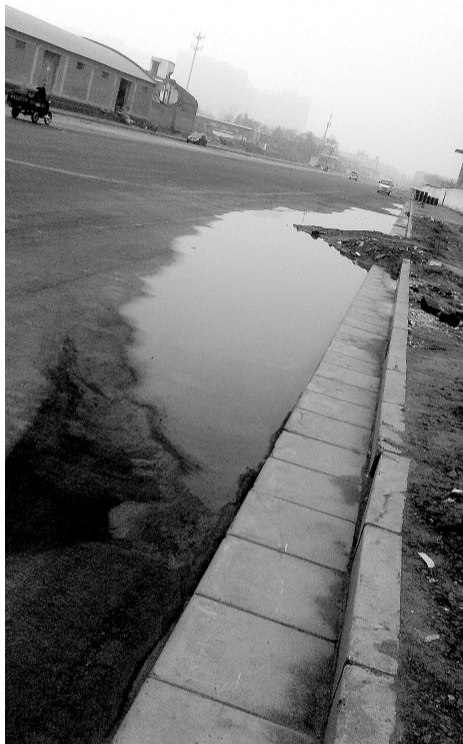
在该路南头正商新蓝钻E区工地西侧的路面上,残留着大片污水。
