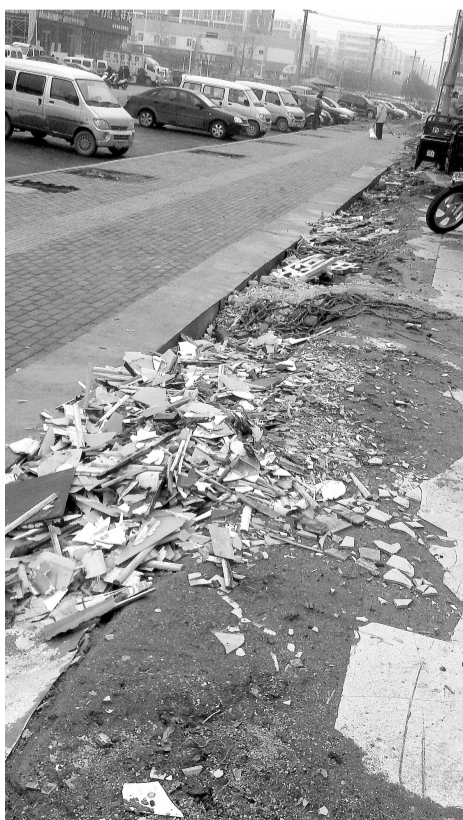
魏庄西街东侧就是豫州电动车批发市场西门,道路红线一带,堆积着大堆的装修垃圾。
