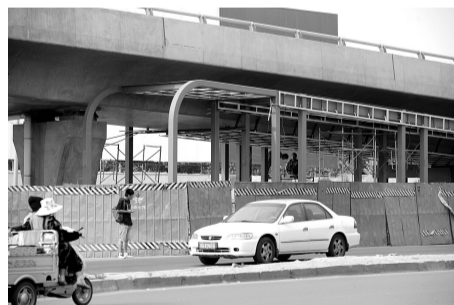
农业路一层东北角桥下正在施工的BRT公交站台，施工完成后，原来农业路上的公交站台将被拆除。
