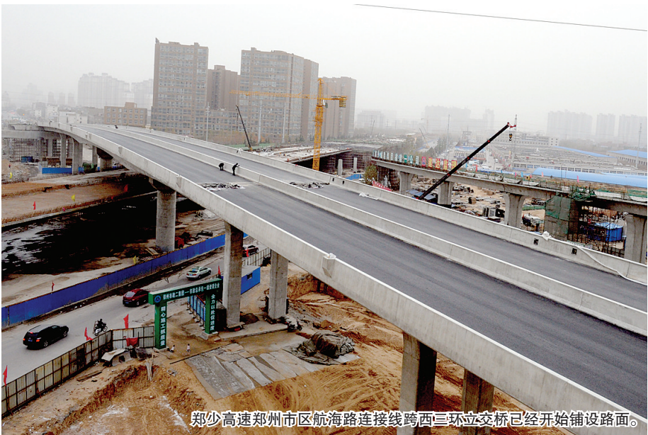
郑少高速郑州市区航海路连接线跨西三环立交桥已经开始铺设路面。
