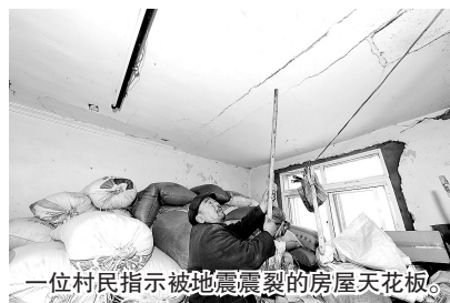
灯塔市柳条寨镇在地震中受损的房屋。
