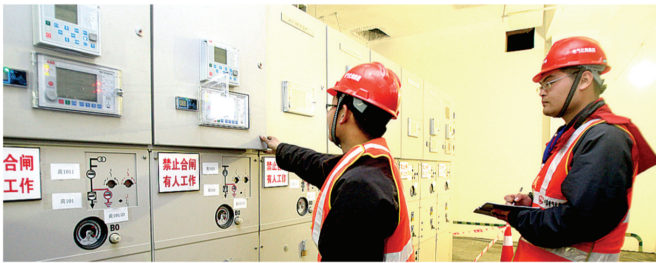
技术人员在检查配电箱的工作状态。
