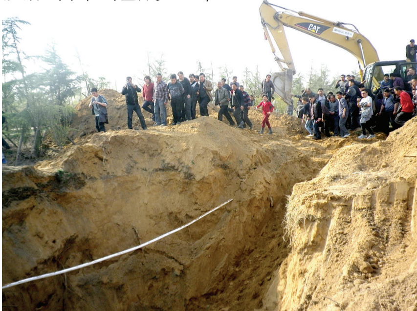
塌方现场形成一个5米深的坑
