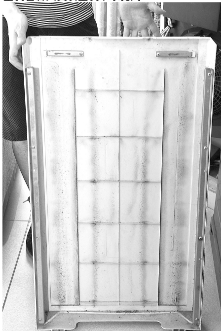
柜机的进风口处挡板上污渍斑斑
