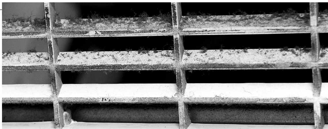
空调柜机的进风口处沾满了污物
