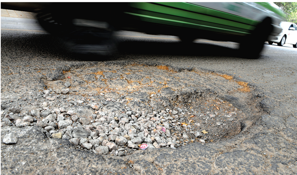
郑州市华山路伊河路交叉口处,一个十几厘米深、五十厘米宽的大坑让过往汽车避让不迭。
