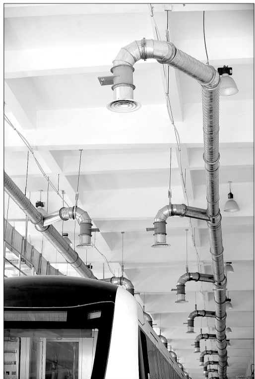
这一根根管道可吸附车厢上方表面的灰尘。
