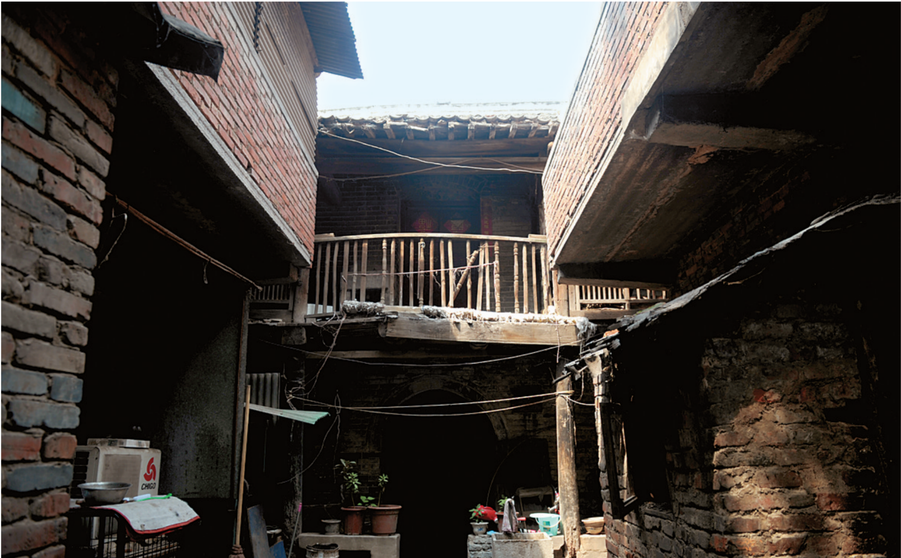
这座饱经沧桑的二层小楼摇摇欲坠,已成危房,没有人居住。
