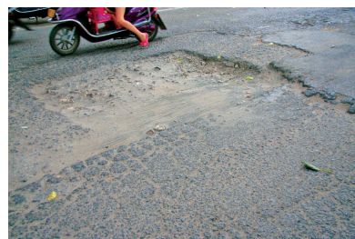
登封市少林大道与滨河路交叉口隐藏的大坑。
