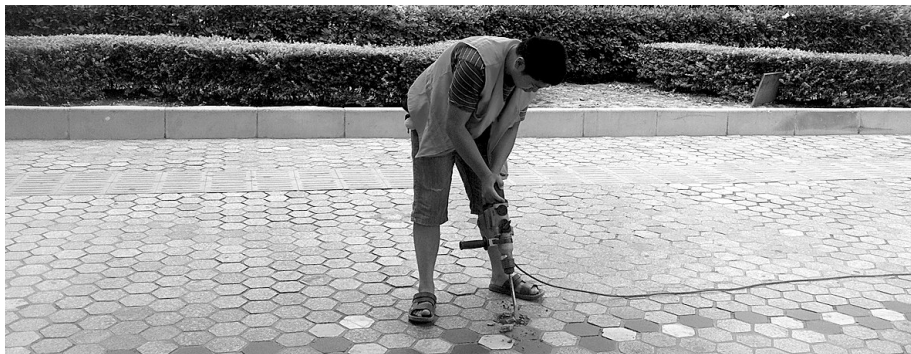
市政管理人员认真地清理破损的行道砖
