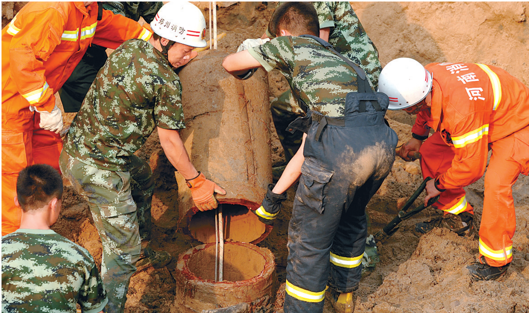
每挖深一些,消防官兵就将水泥井管夫掉一截。郑州晚报记者 周勇 图
