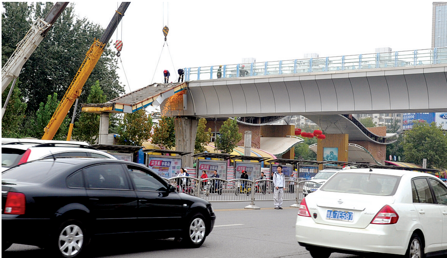
昨日下午,工人在拆除花园路动物园门前的人行天桥,一名行人从桥下翻越路中护栏。
