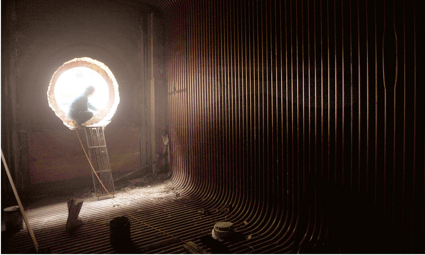
锅炉本体内已全部安装就绪,工人们正在为将它与燃烧机安装对接而做准备工作。
