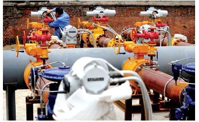
天然气调压箱占地面积也不小,所以设计人员把它配置在了锅炉房外面。
