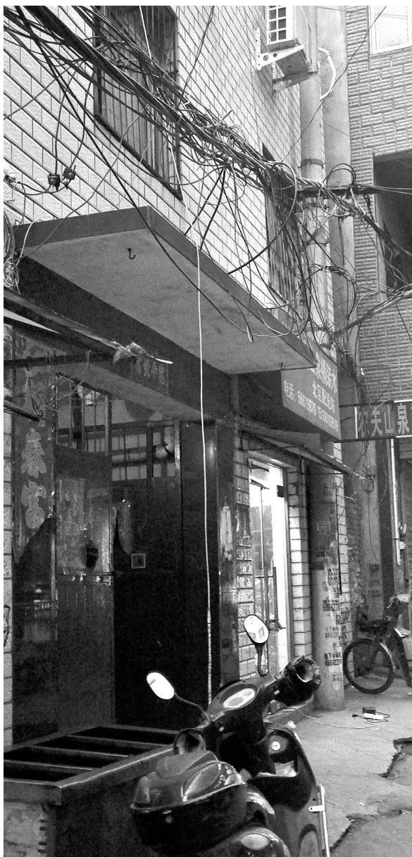
昨日,黄家庵村内,住户从楼上私扯电线为电动车充电。
