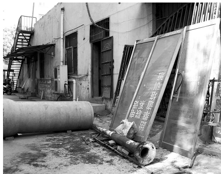
业主封了热交换站,整个湖光苑小区没法供暖
