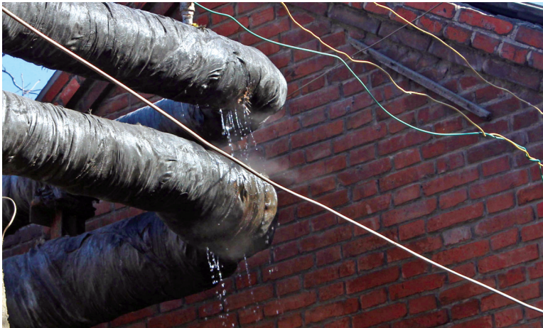
司家庄西街与凌云路交叉口西侧的4号院大门口,热力管道不停地向下漏水。
