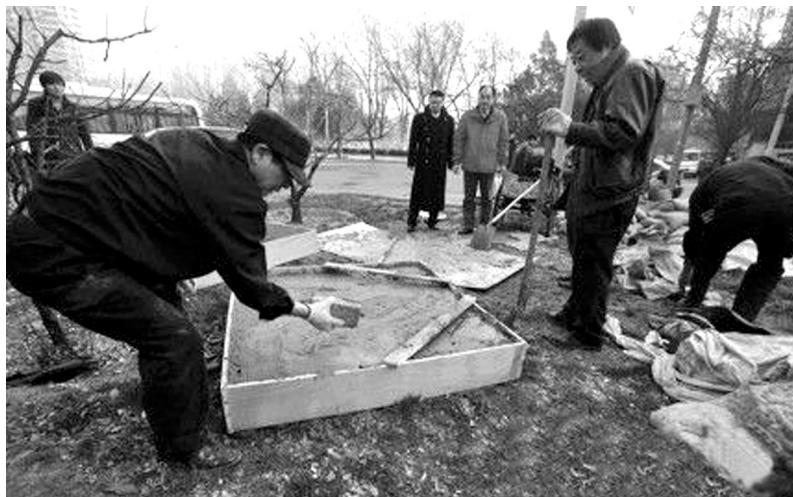
媒体报道打工者在地下井住了近20年后,昨天上午,记者再次来到住人井附近,发现北京将台乡政府已经派人开始用水泥将住人井井口封死,并将井内东西掏出。一位执法者称,早上5点多钟在此看到,有住井者携带值钱物品已经离开。法晚
