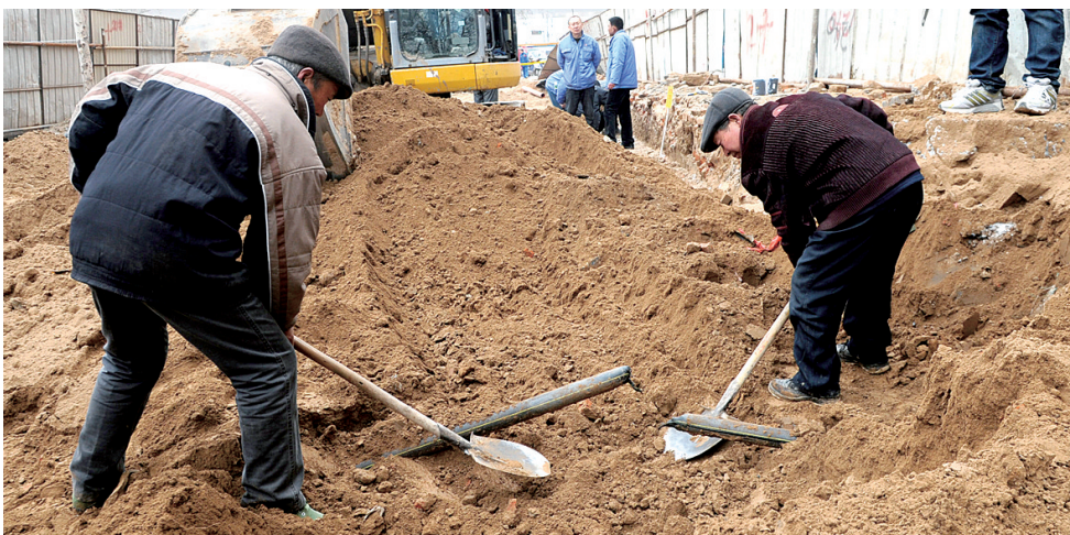
丰庆路上被挖掘机挖断的燃气管道
