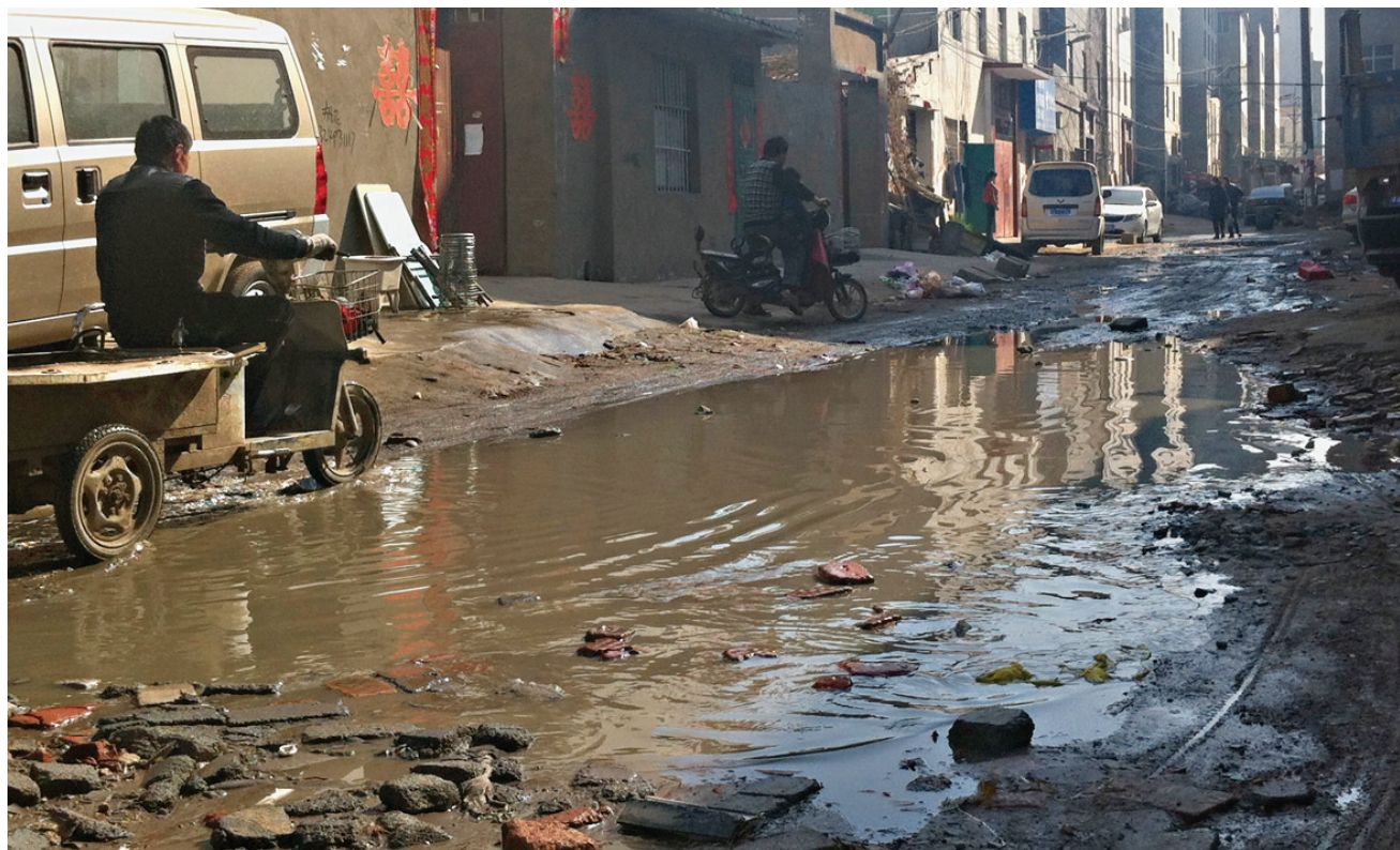
螺蛳湖村内,路面损坏积水成塘
