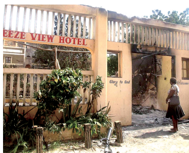
被烧毁的建筑物
