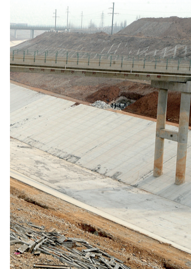
焦作铁路交错，中线黄姜工程共包含铁路交叉建筑物14座，其中焦作市境内有10座。
