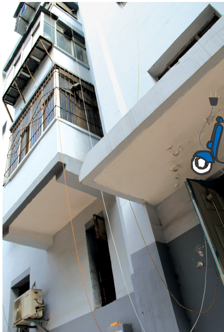
送变电社区西区5号楼前私拉电线充电
