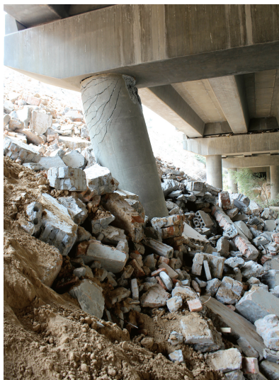
巨大的水泥桥墩被建筑垃圾顶歪。
