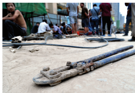
绞断线缆的钳子还扔在现场
