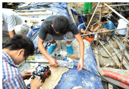
技术人员紧急抢修被绞断的线缆。
