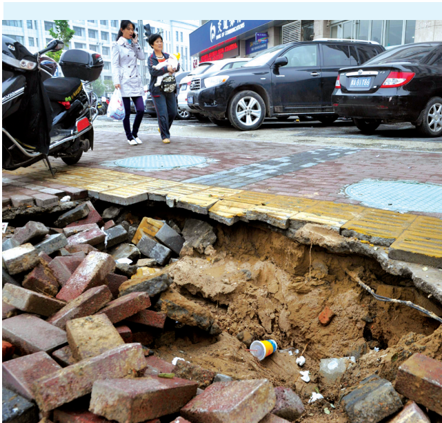
中原路京广路口东北角 出现半米深塌陷
