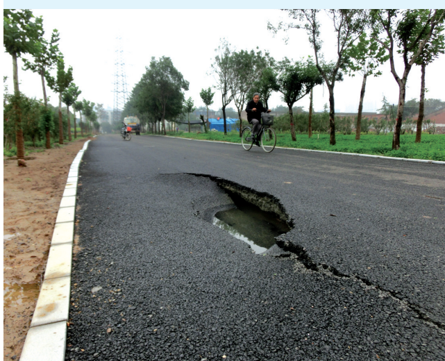
新修不到一个月的柏油路 雨后裂开一个长口子
