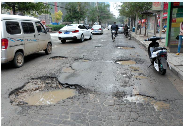
天明路(东风路至农业路段) 大大小小竟有100多个坑
