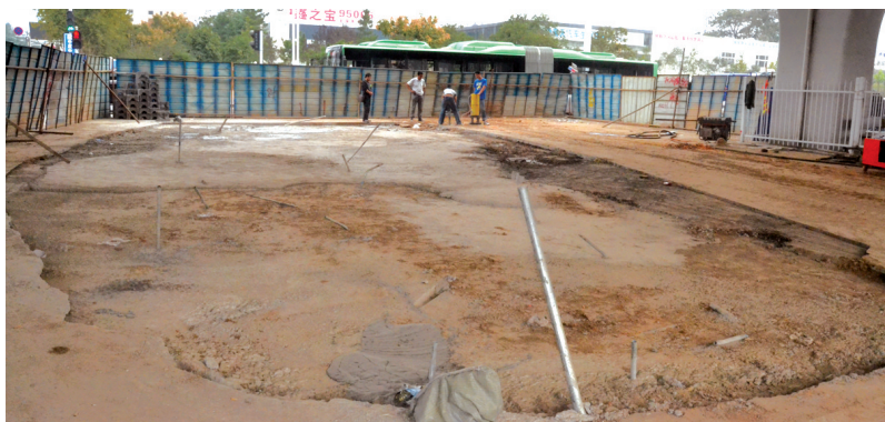
中原路塌方最大的塌坑
