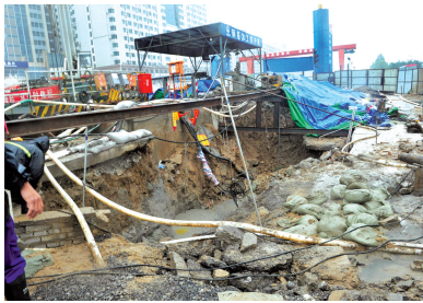
国基路与花园路交叉口塌陷的大坑。
