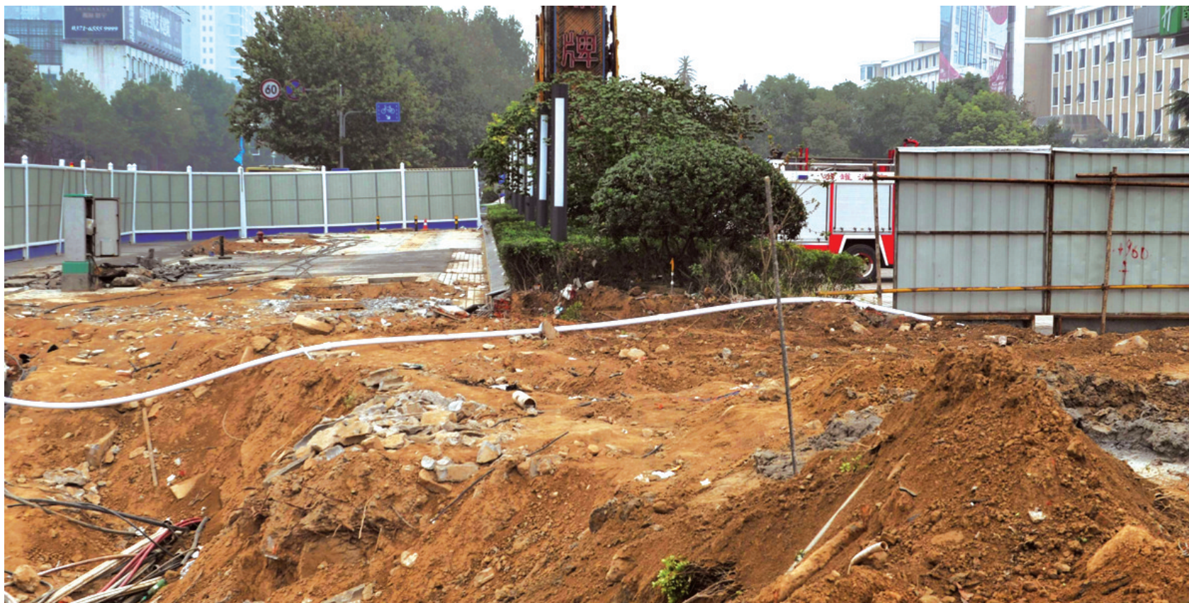
因酒店阻碍施工,经三路下穿金水路隧道工程已拖延一个半月。郑州晚报记者 周甬 图
