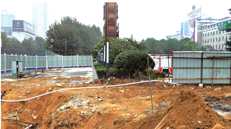
金水路经三路交叉口附近的下穿隧道,因为无法拆除部分花坛,导致保通路工程动不了工。
