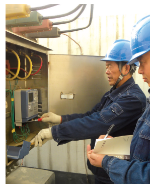
测试变压器运行温度
