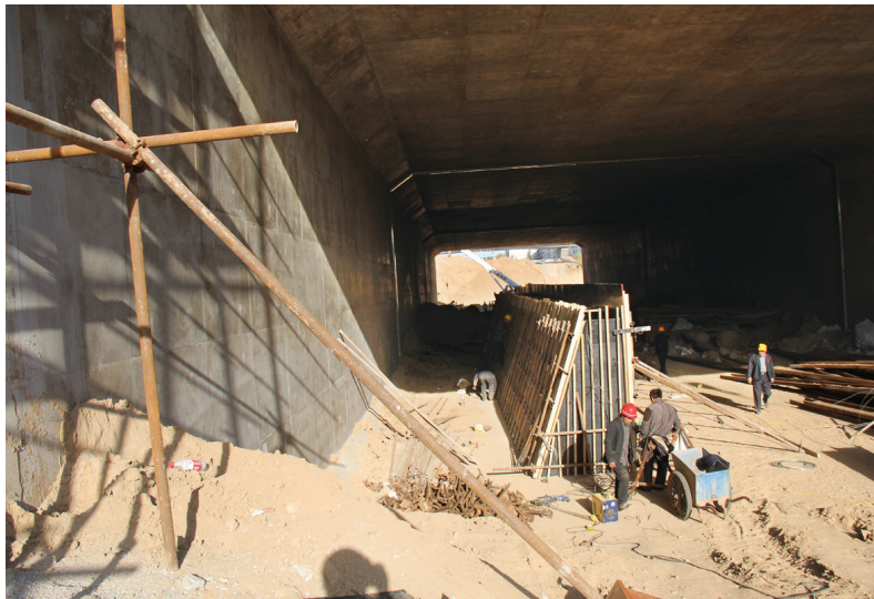
箱涵对顶成功,工人正在做非机动车道与机动车道的隔离
