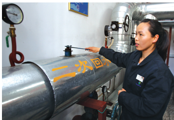
工作人员陆续开启热交换站开关。
